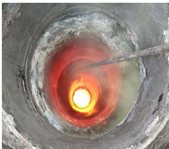
图 5 柳钢二焦运行 1 年的荒煤气换热器内部照片
